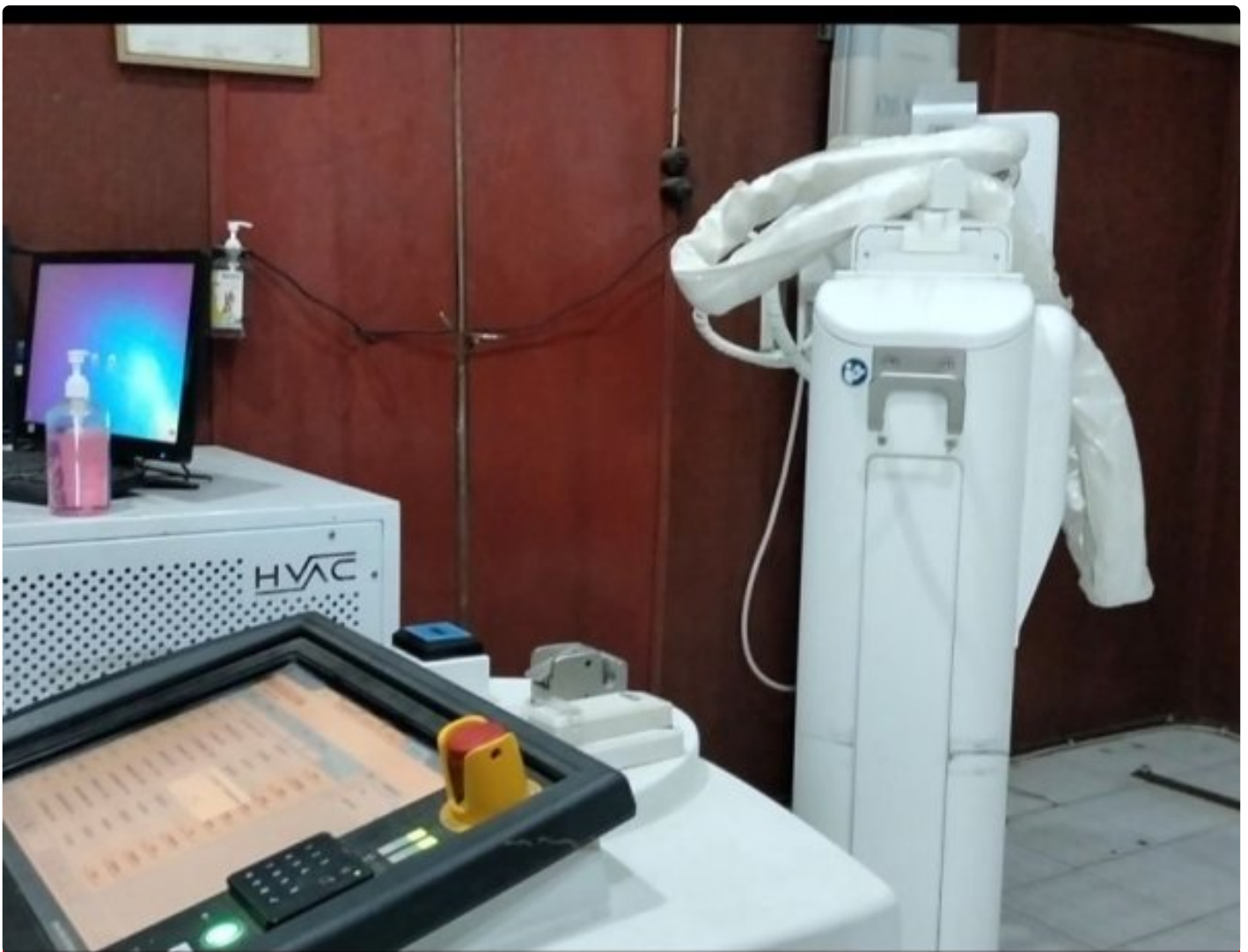
Alat Radiologi Rontgen RSUD Kabanjahe, yang dibiarkan rusak, Rabu (03/01-2024)
